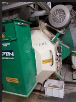
Una delle macchine adibite alla pellettizzazione
